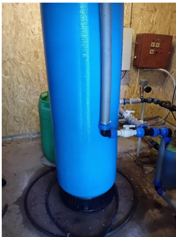
Foto 5-8 Peningi küla puurkaevpumpla välis- ja sisevaade
