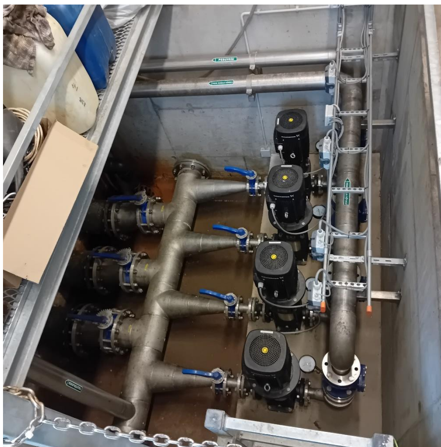
Foto 5-2 Aruküla pumpla nr 3 sisevaade, võrgupumbad
