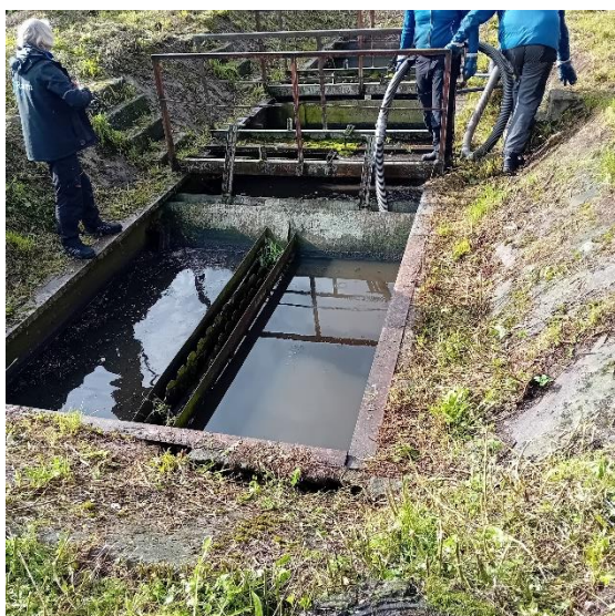
Foto 6-6 Härma amortiseerunud reoveepuhasti BIO-50
